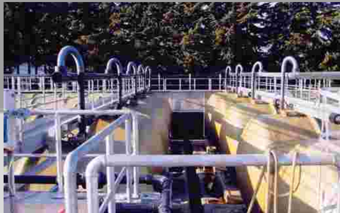
Batteria serbatoi orizzontali per percolato, diametro 3.000 mm, capacità 70 m 3 .
