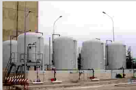
Batteria serbatoi verticali a fondo piatto per clorito sodico, diametro 3.000 mm, capacità 35 m 3 .
