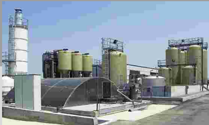
Batteria serbatoi e decantatori per impianto smaltimento rifiuti industriali.
